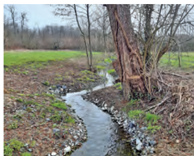
2 - Recharge granulométrique sous forme de banquettes - Exemple de mise en œuvre (SMBVAR)
